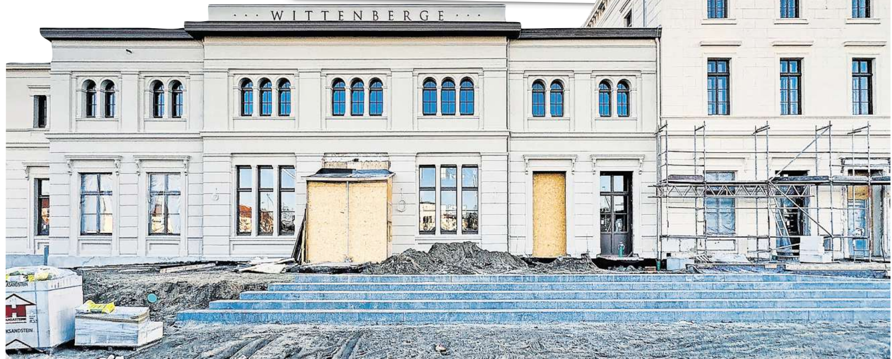
Das Bahnhofsgebäude in Wittenberge wird im Juni nach der Sanierung offiziell eingeweiht. Fotos: Martin Ferch
